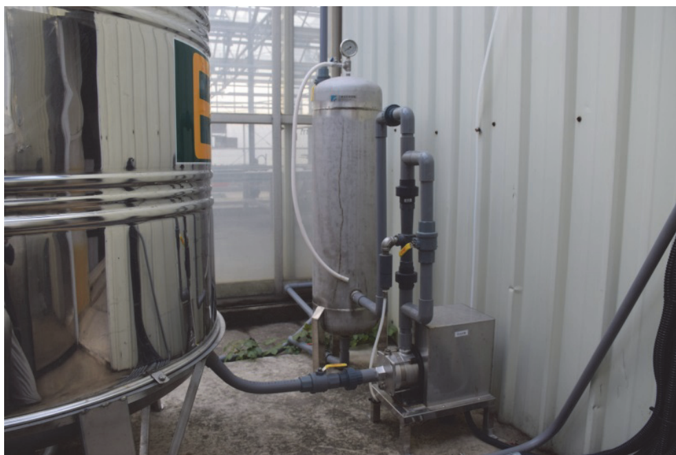
圖 4. 臭氧氣水混合裝置
