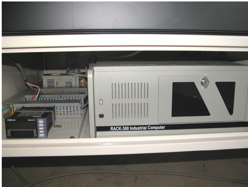
圖 4. 控制系統外貌 Fig. 4. View of control system.
