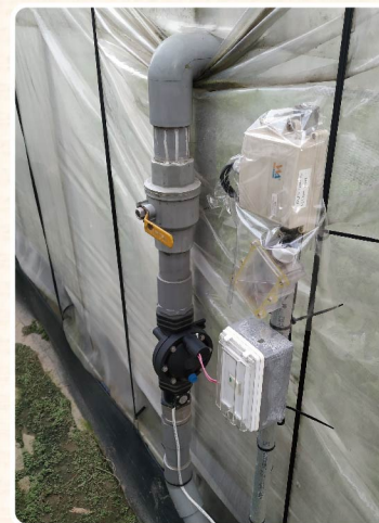
▲ 設施葉菜溫室安裝灌溉控制器及電磁閥
