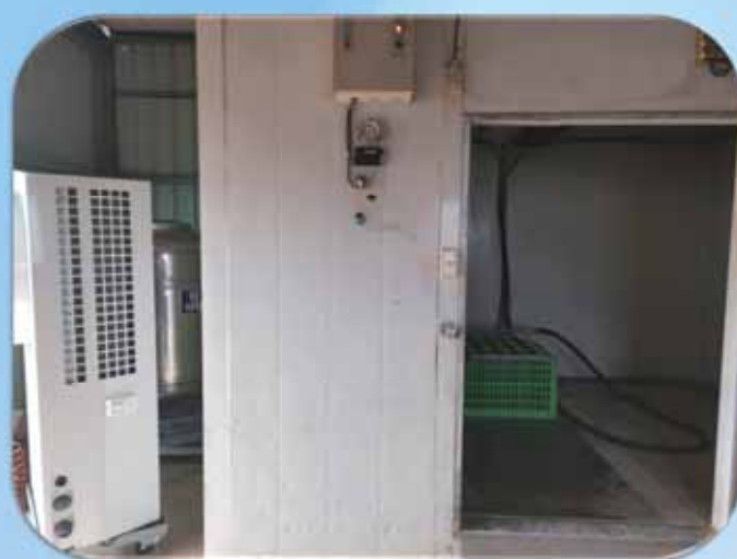
冷水機系統含保溫水槽、定時 裝置、淋水架、沉水馬達及 16KW冷水主機等設備
