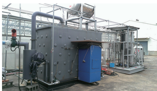
生物質燃燒爐連接氨水吸收式製冷系統
