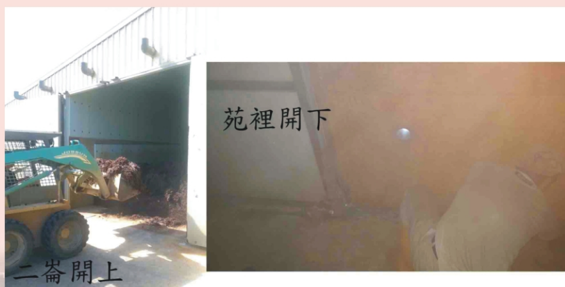
▲ 圖3. 二崙鄉及苑裡鎮發酵通風設備
