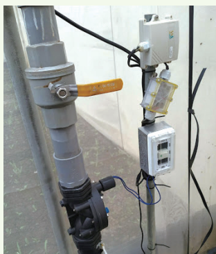
▲溫室灌溉管路安裝控制器及電磁閥，依據累積光度自動灌溉。
