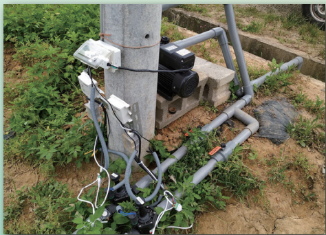
▲以無線傳輸控制器控制電磁閥啟閉，灌溉量上傳雲端系統。
